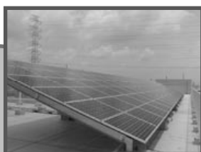
太陽光発電設備
